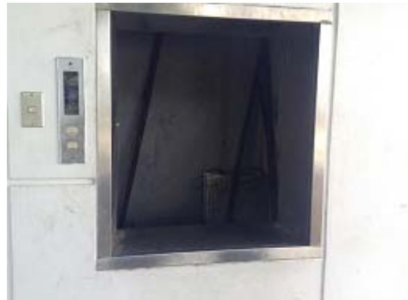
（右）C工場の料理搬送用エレベーター
